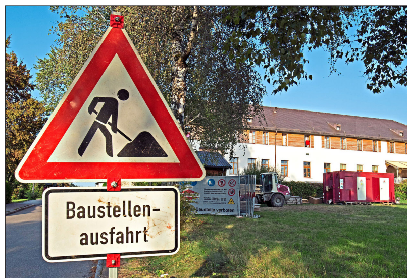
Am Feuerwehrholungsheim wird bereits umgebaut und saniert – noch bis mindestens April 2017. Der Bauherr, das Staatliche Bauamt Traunstein, beantragte nun eine Ausnahme von der Ruheverordnung bis Weihnachten. – Foto: Bittner
